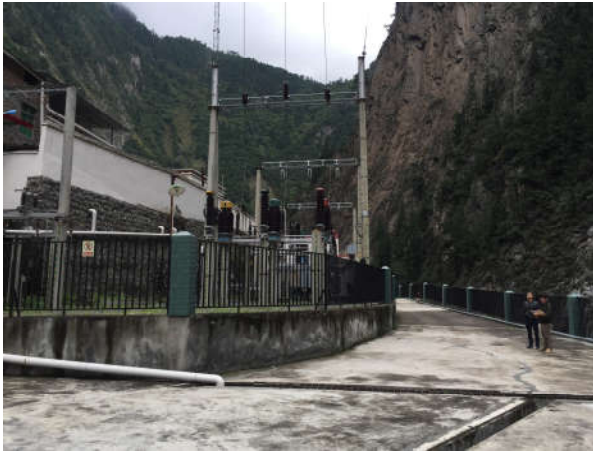
一颗印 110kV 升压站布置
