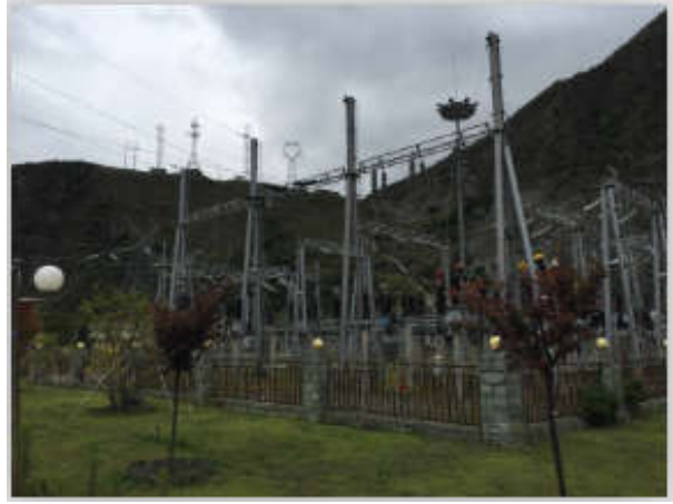
红叶二级水电站 220kV 升压站间隔
